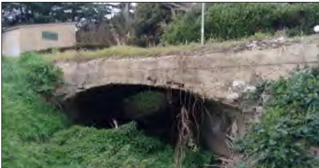
Imatge 12. Obra de pas de la riera de la Vallmanya al seu pas pel Carrer Vallès.
